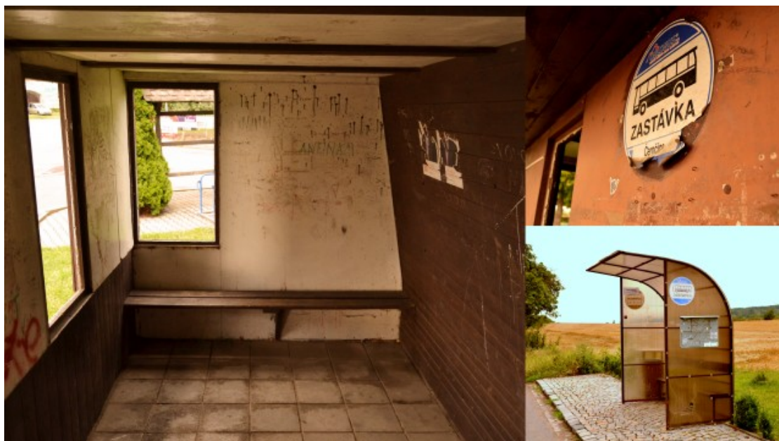
Autobusové zastávky jsou ve špatném stavu.
